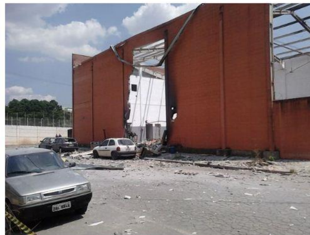
Caldeira explodiu em fábrica em pólo industrial de Mauá (SP) Foto: Marcelo de Almeida / Agência Olycom Repórter
